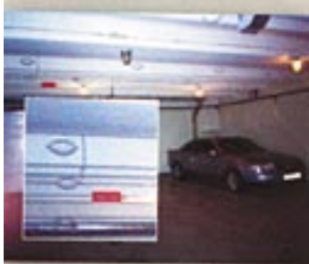
Размещение модулей «Буран-2,5» в помеще- нии гаража, расположенного в подвале жилого многоквартирного дома
